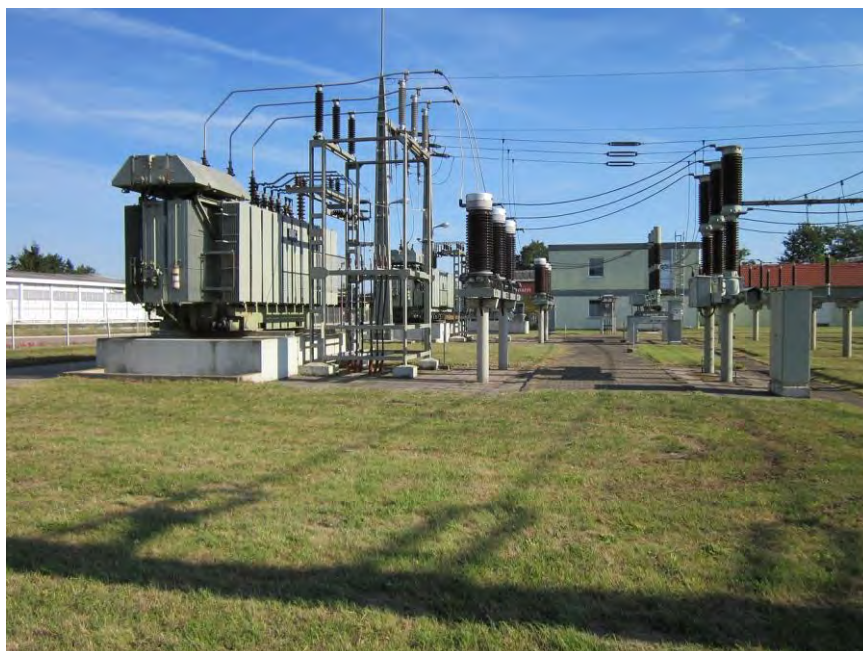
ТС 110/35/10 kV "Пожаревац 2"
